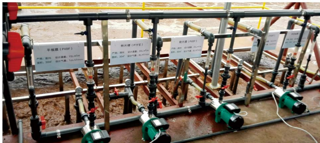
浙江大港印染厂生化好氧池
